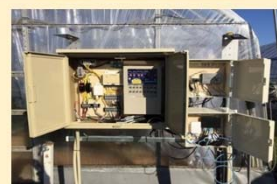
試験場内YoshiMax設置状況
